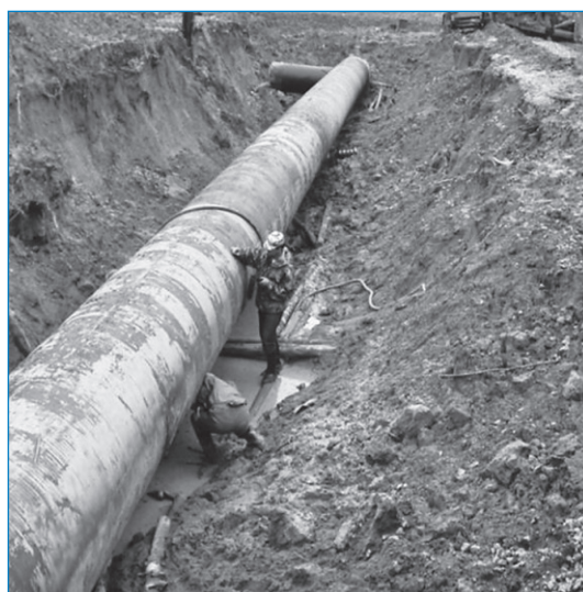
Рис. 2. Обследования протяженных участков МГ в шурфах с помощью портативных вихретоковых дефектоскопов
